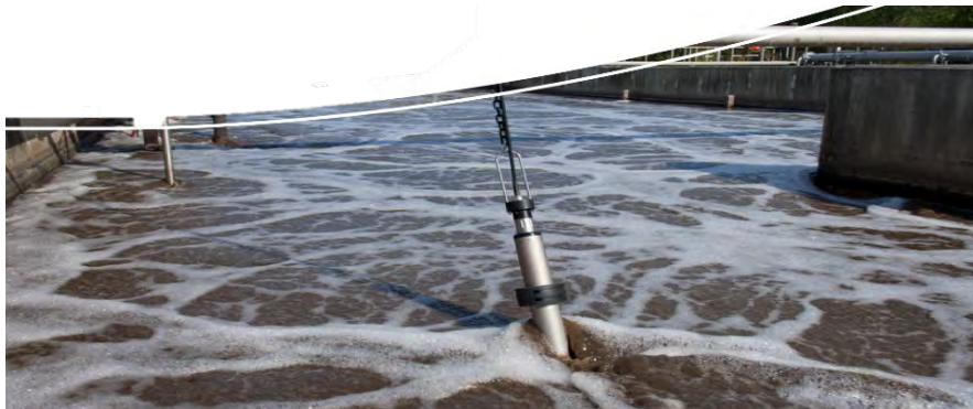
Figura 9.- Planta de tratamiento de aguas residuales de la URAI
