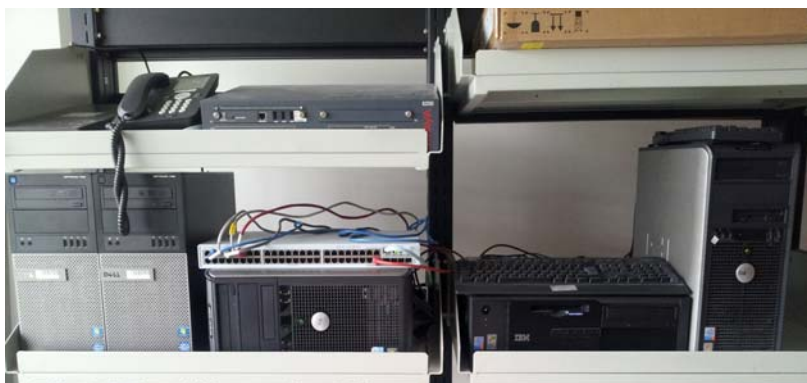
Fotografía 2. Servidores del COR-UIS
