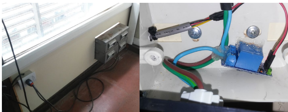
Fig. 5. Sistema de ventilación automático del Data Center. Observa la conexión del impulsor de aire (izquierda) con el actuador relé instalado dentro de la caja del tomacorriente (derecha).
