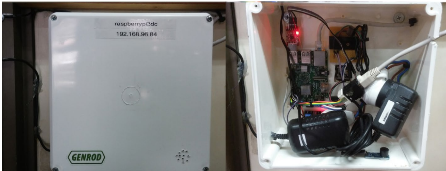
Fig. 9. Montaje de Raspberry Pi 3 en Sala de Servidores.
